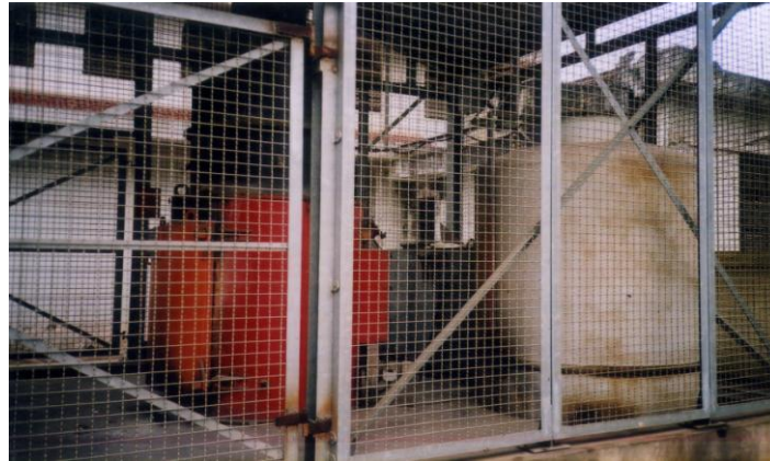
Hình 3.3 - Lò đốt Hoval MZ2 tại bệnh viện Đa khoa Sơn Tây.
