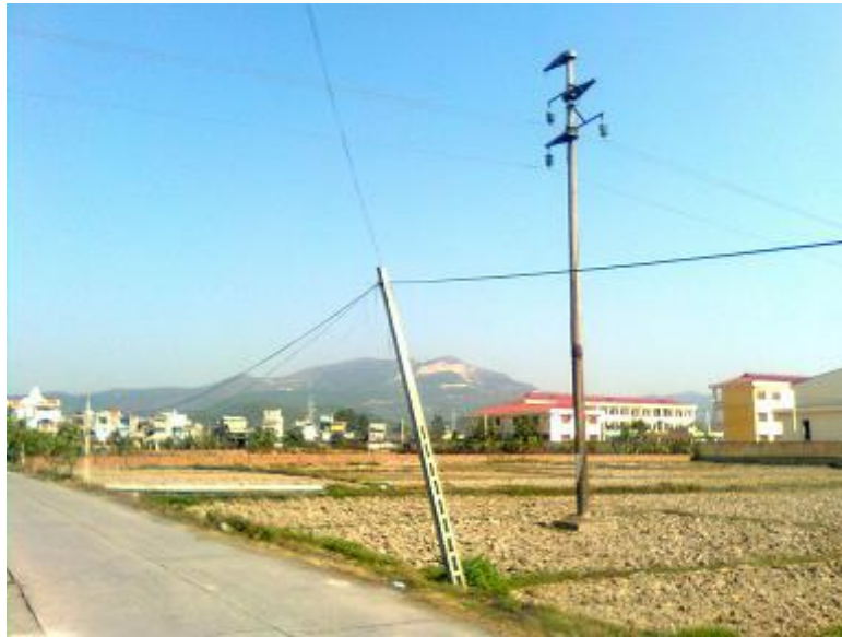
Cột điện xuống cấp – gây nguy hiểm
