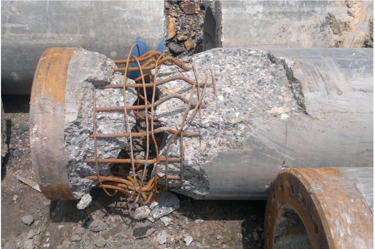
Hình 2.4.3 Cọc bị vỡ đầu do mác bê tông kém
