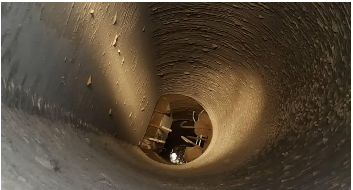
Hình 2.4 . 13 Cọc bị gãy ngang thân nhô bên trong lòng cọc
