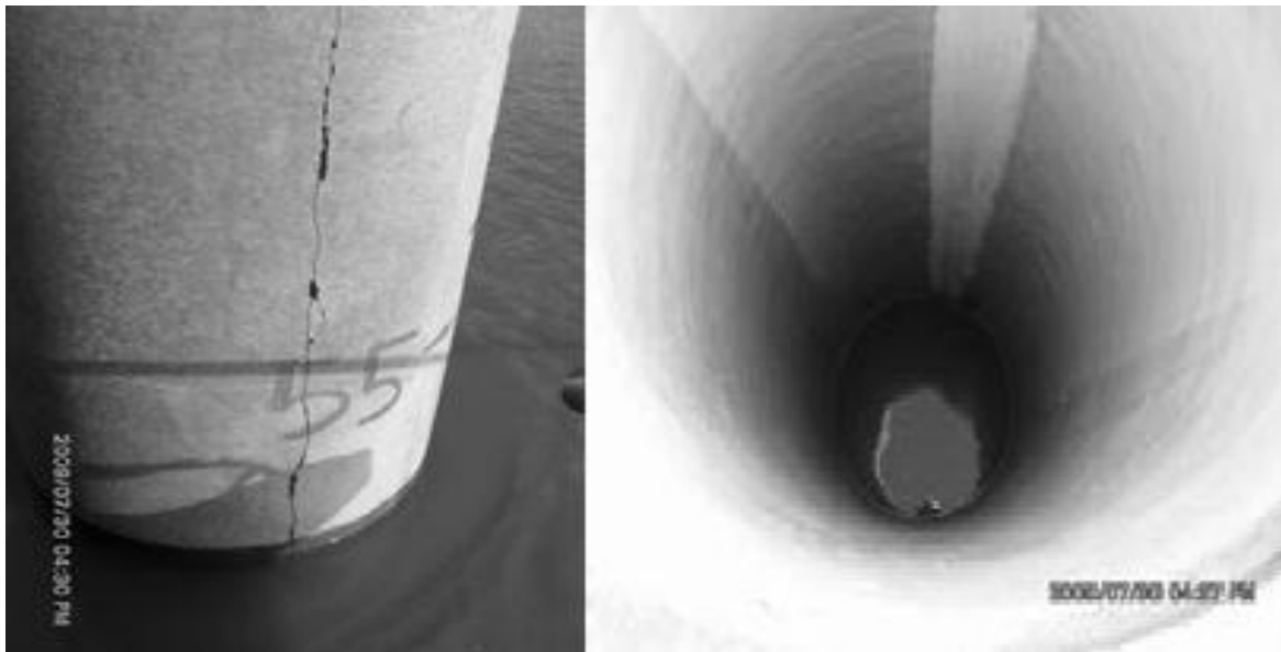
Hình 2.4.7 Vết nứt dọc (nhìn bên ngoài và bên trong lòng cọc)
