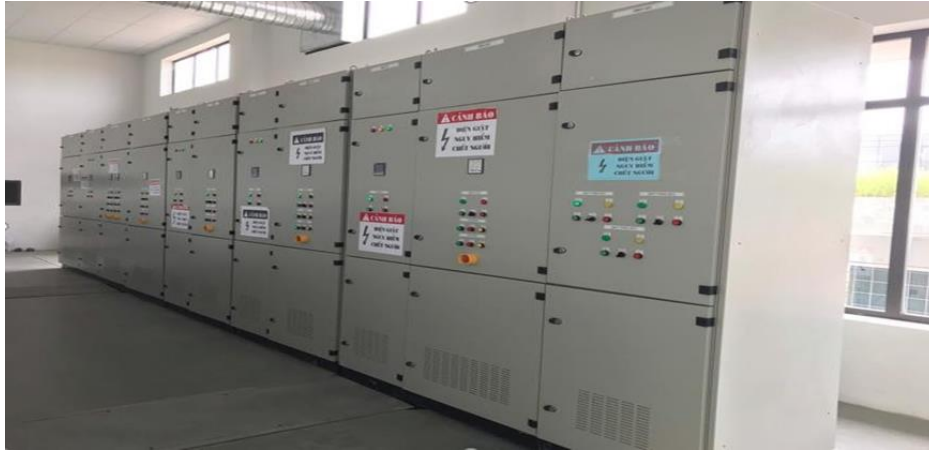
Hình 2.2: Tủ trạm bơm nước sạch
