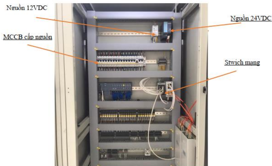
Hình 2.22. Tủ DB03 - Tủ DB03-PLC
