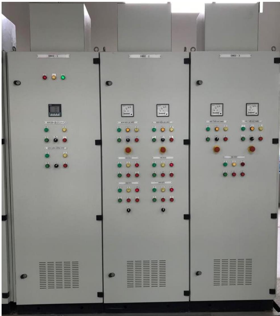
Hình 2.16. Tủ DB01-4/3 Dàn tủ DB02
