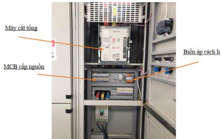
Hình 2.7. Tủ DB01-2/1- Tủ điện tổng máy biến áp 6
