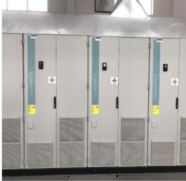
Hình 2.13. Dàn tủ biến tần
