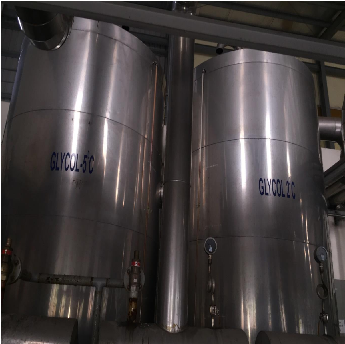
Hình 3.7.1. Hình ảnh tank chứa Glycol
