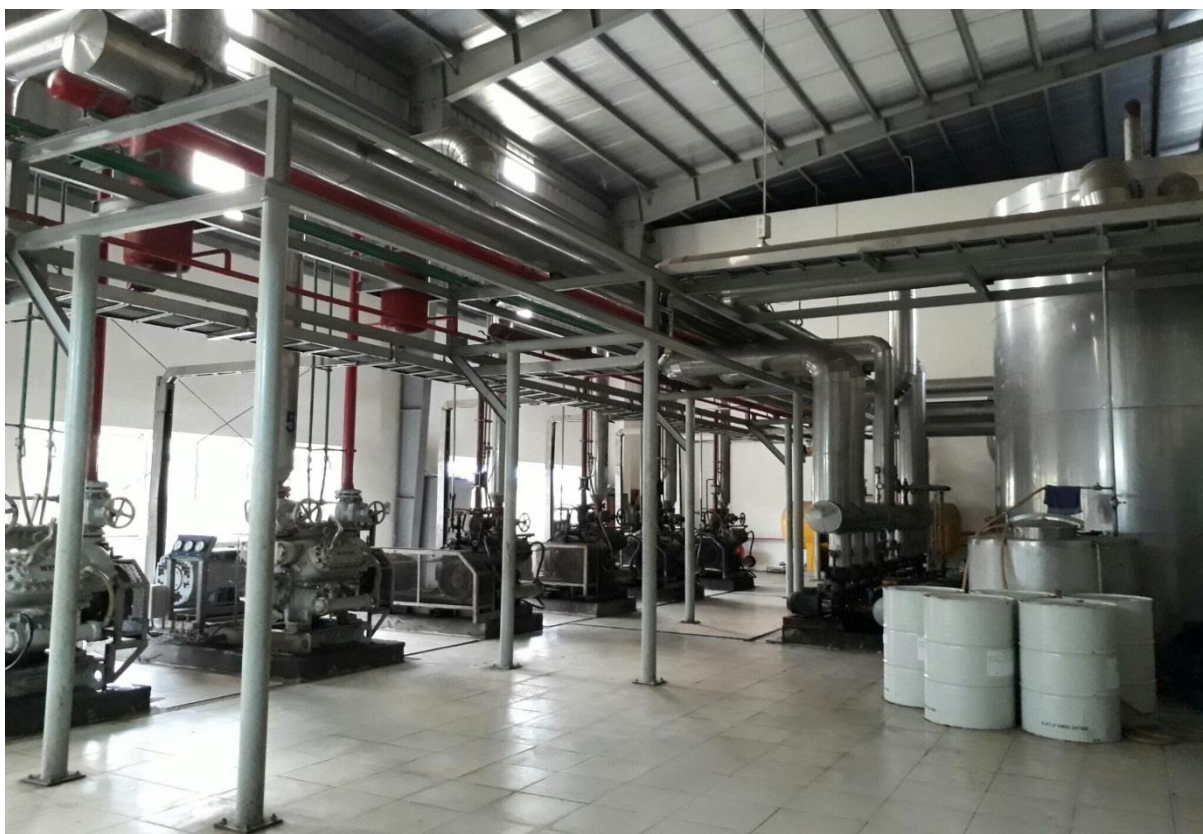
Hình 3.1.3. Toàn bộ hệ thống lạnh.
