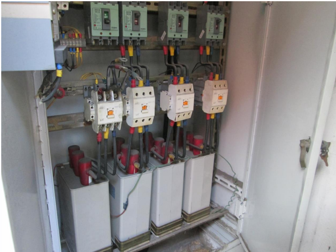
Hình 2.8. Tủ tụ bù
