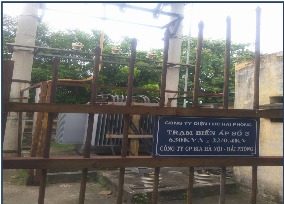
Hình 2.6. Máy biến áp 630KVA
