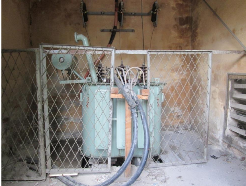
Hình 2.5. Máy biến áp 560KVA
