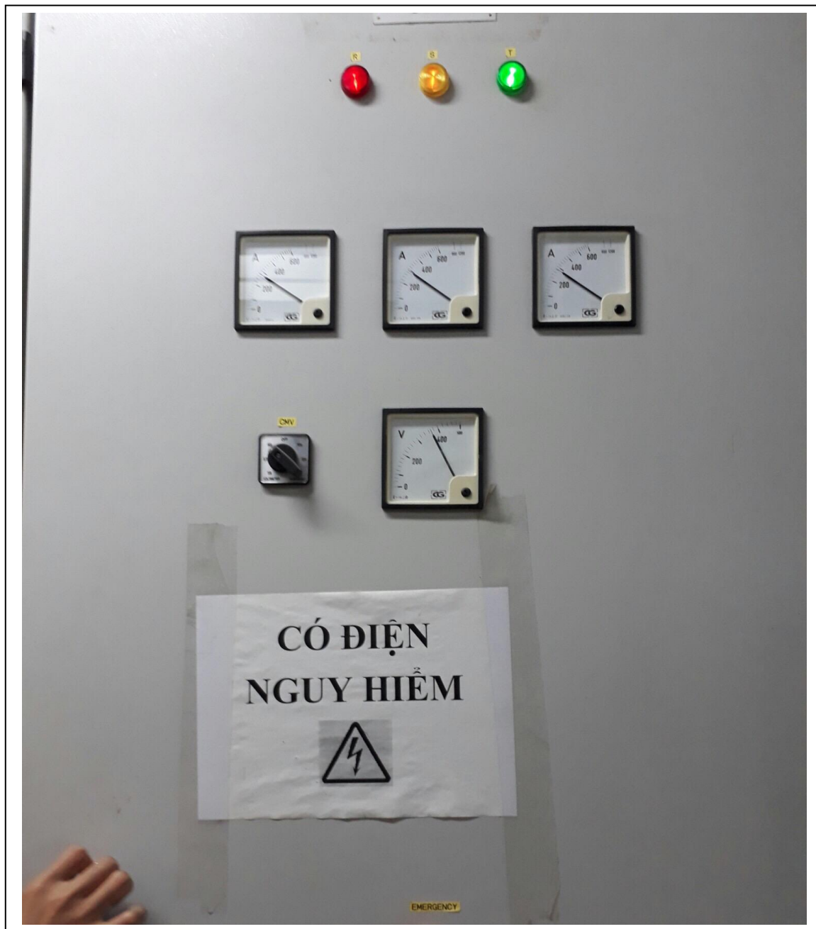
Hình 3.1.5. Hình ảnh mặt ngoài tủ điều khiển
