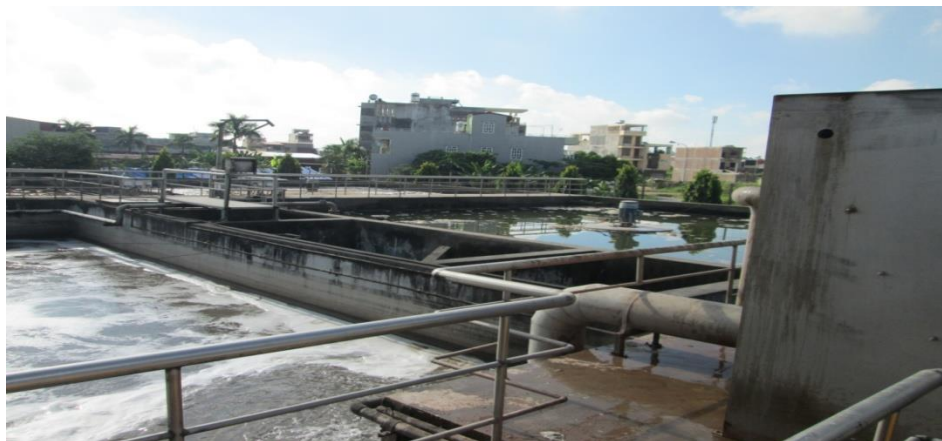
Hình 1.14. Hệ thống xử lý nước thải.
