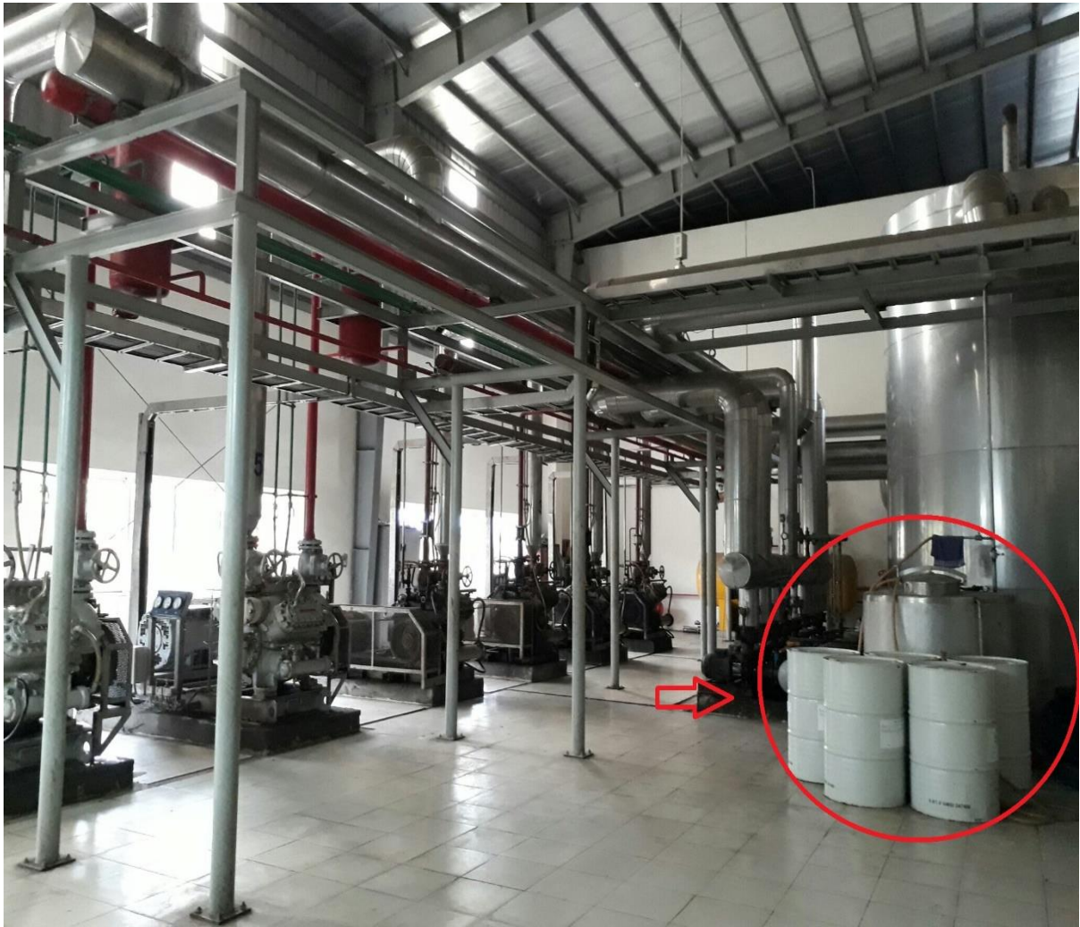
Hình 3.7.4. Tank chứa Glycol bổ xung
