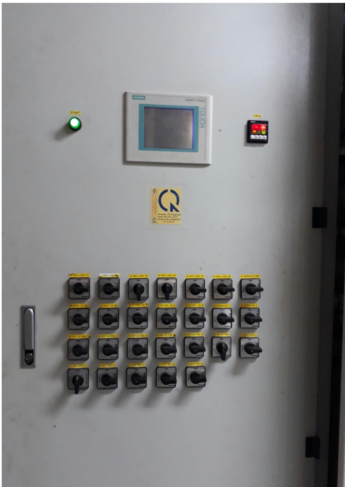
Hình 3.8.1. Các công tắc COS điều khiển hệ thống lạnh
