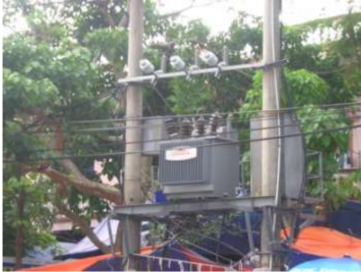
Trạm biến áp 6kv
