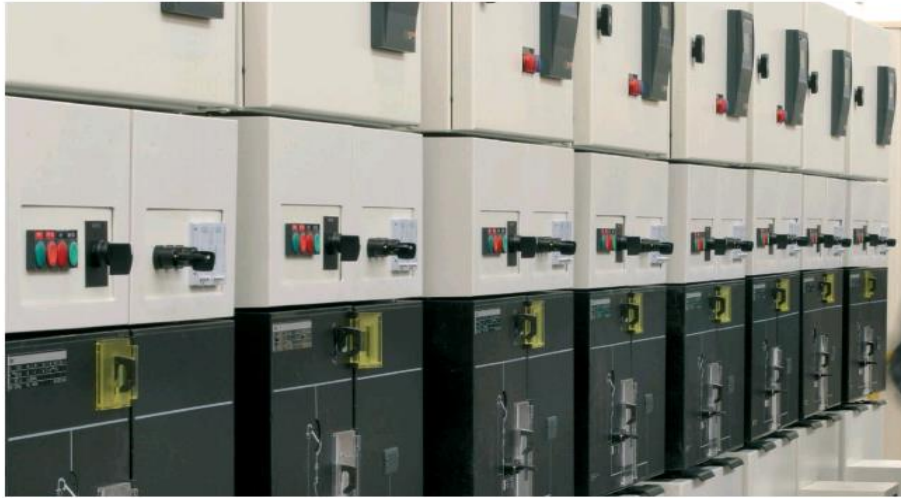
Hình 1.4. Hệ thống tủ hợp bộ trung áp hãng Schneider.
