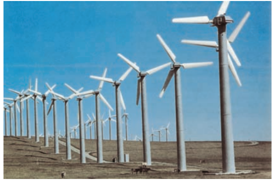
Hình 32.3. Trạm phát điện năng lượng gió
