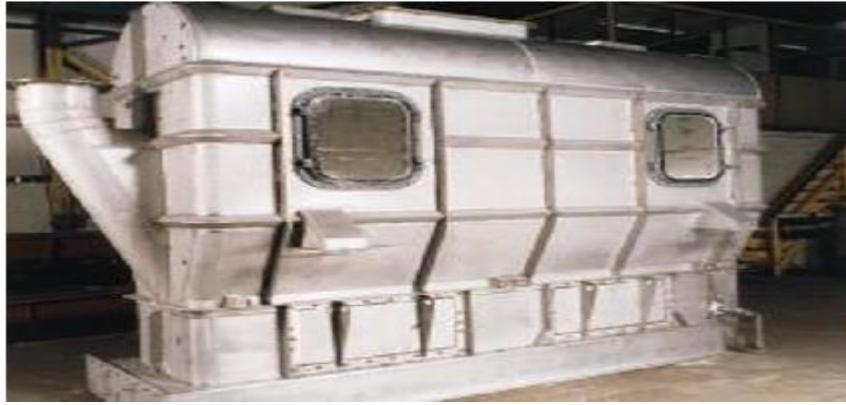
Hình 2.8: HTS tần sôi trong nhà máy đường
