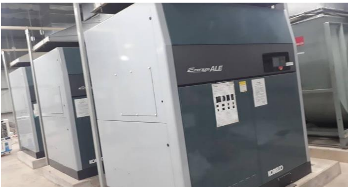
Hình 1.4: Hình ảnh về hệ thống máy nén khí.
