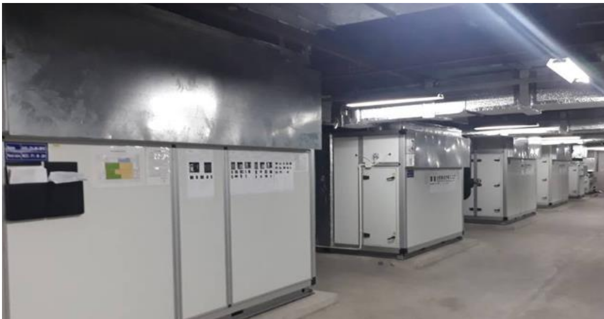
Hình 1.3: Hình ảnh về hệ thống AHU.
