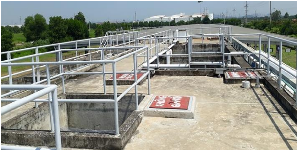
Hình 1.9: Hình ảnh về hệ thống khu xử lý nước thải.
