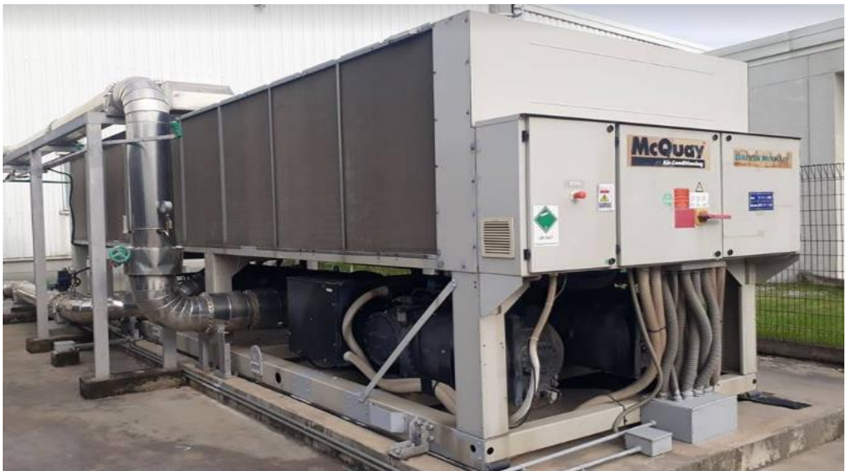
Hình 1.2: Hình ảnh về hệ thống chiller.
