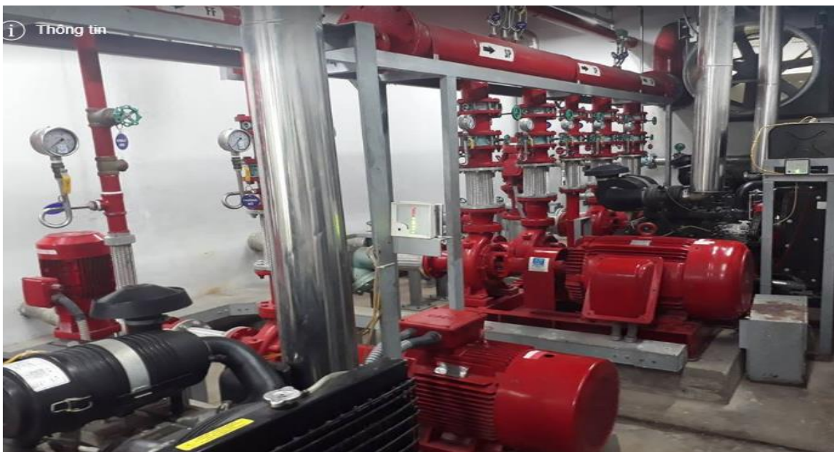
Hình 1.7: Hình ảnh về hệ thống bơm cứu hỏa.
