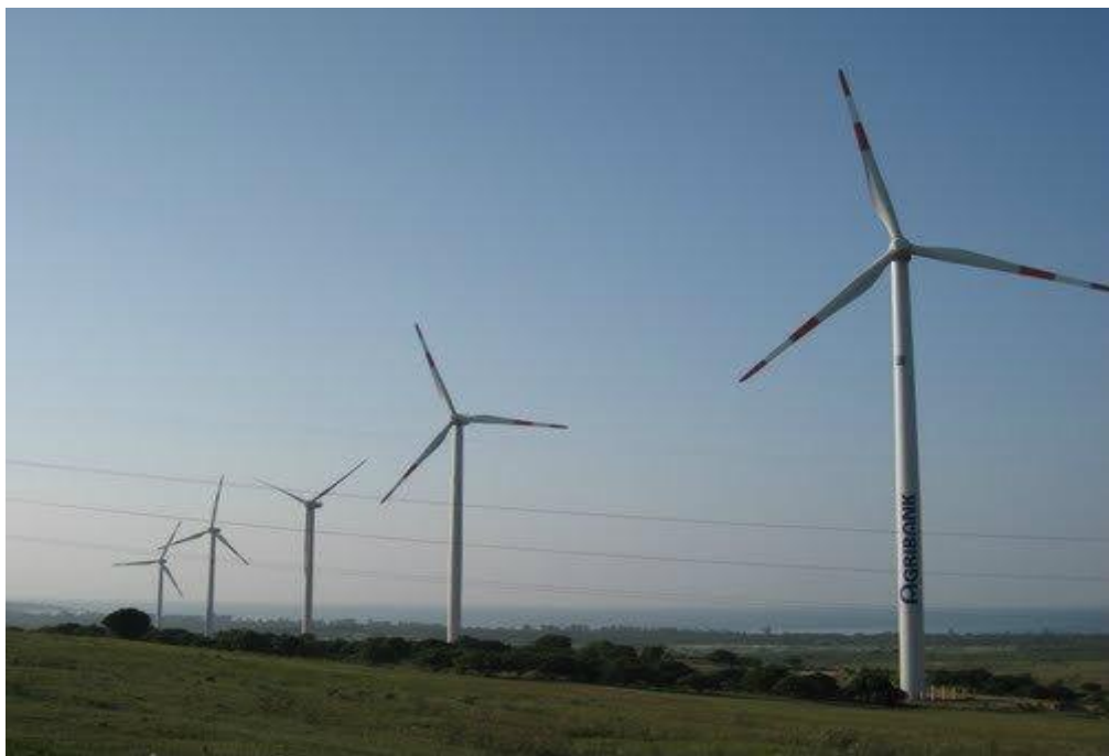
Hình 1.1: Cảnh đồng điện gió Tuy Phong - Bình Thuận
