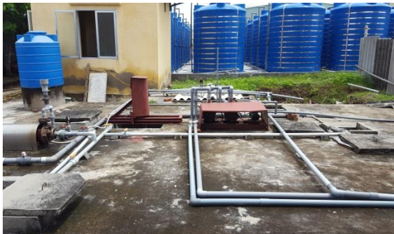
Hình 1. Hệ thống xử lý tại Cát Hải
