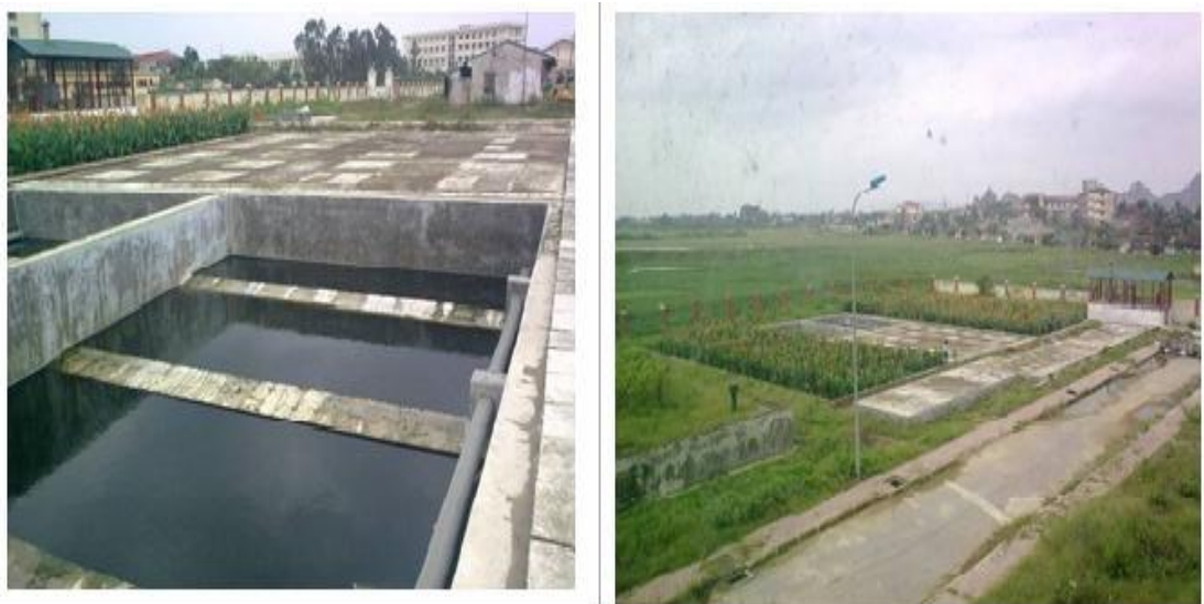
Hình 1.1: Hệ thống DEWATS đã đi vào hoạt động tại bệnh viện Nhi Thanh Hoá
