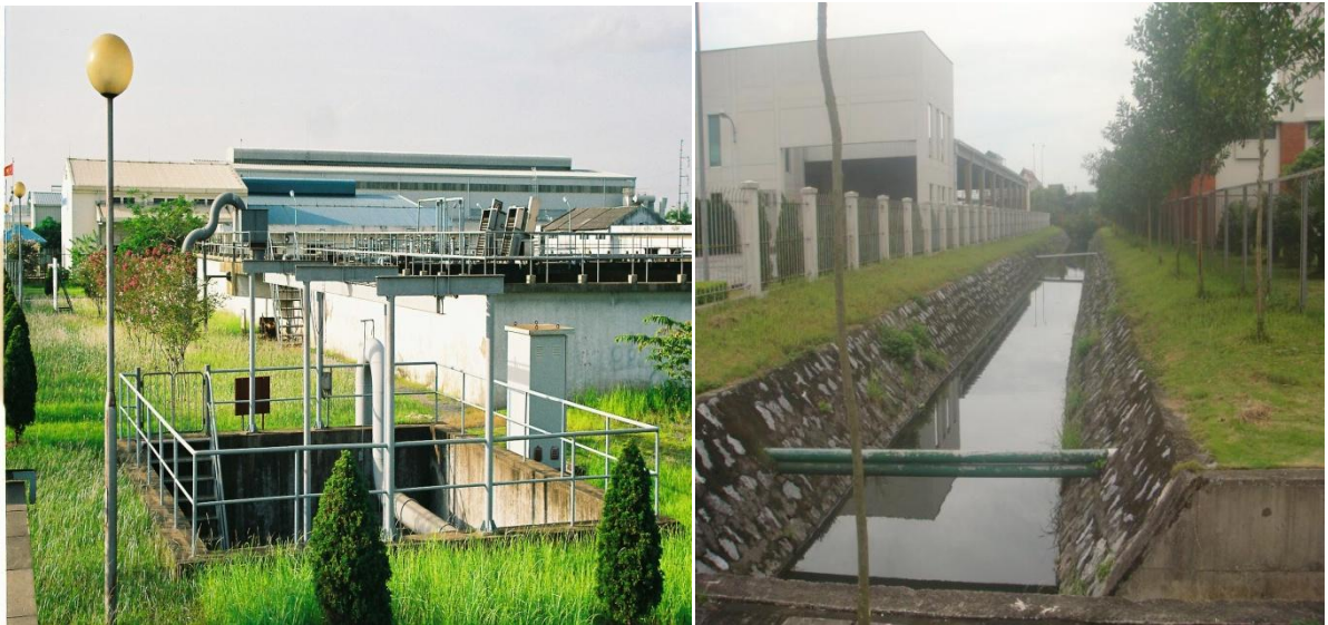
Hình 3.1: Hệ thống ống kênh, khu xử lý nước thải của KCN
