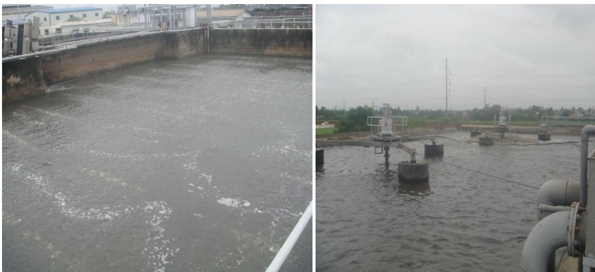
Hình 3.2: Bể xử lý nước thải tập trung của KCN
