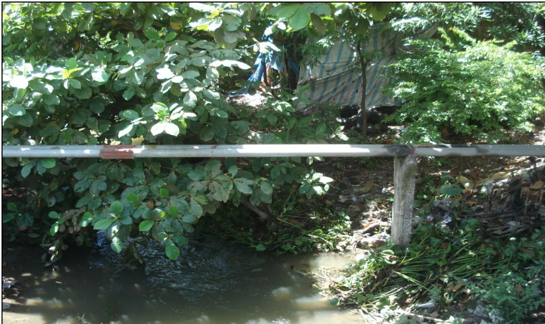
Hình 10 : Đường ống cấp nước
