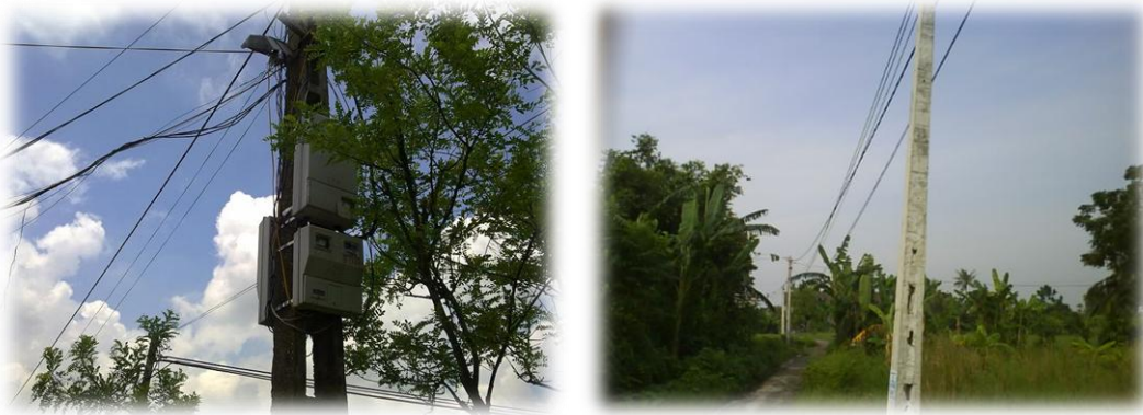
Hình 7: Đường dây điện.
