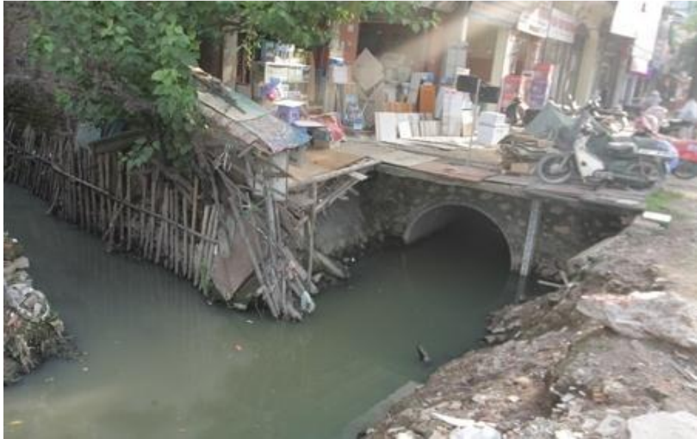
Ảnh: Mương Thanh Nhàn, đoạn mương chưa được công hoá hết.
