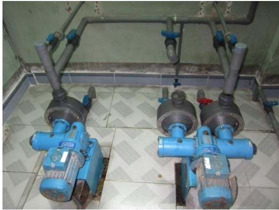
Hình A: Máy bơm phèn
