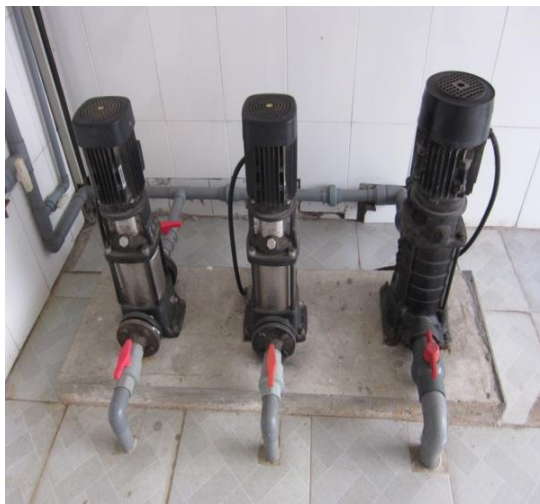
Hình C: Máy bơm nước cho máy châm clo
