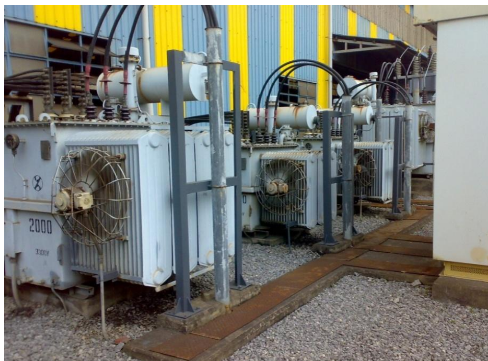
Hình 1.5: Các máy biến áp phụ
