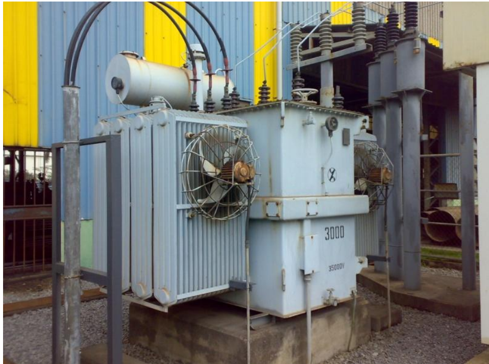
Hình1.4: Máy biến áp chính
