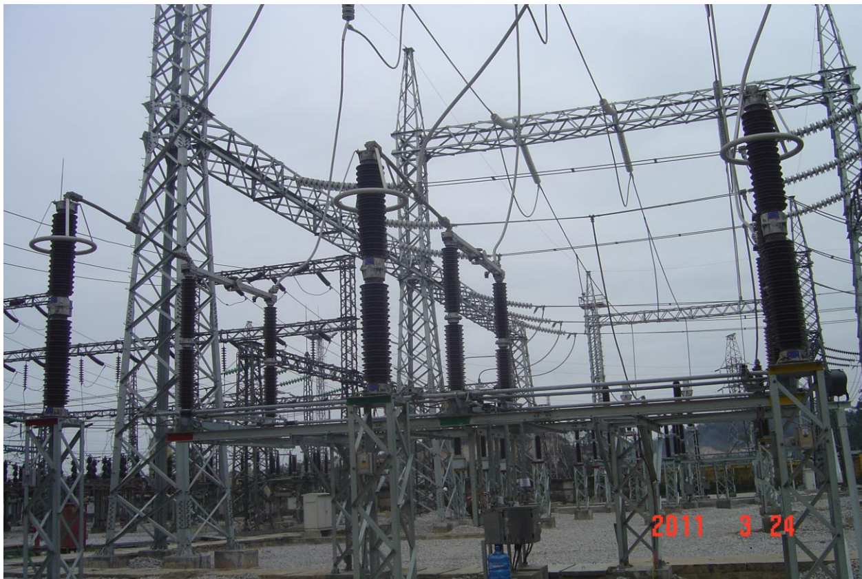
Hình 1-4: Hệ thống thanh cái 220KV.
