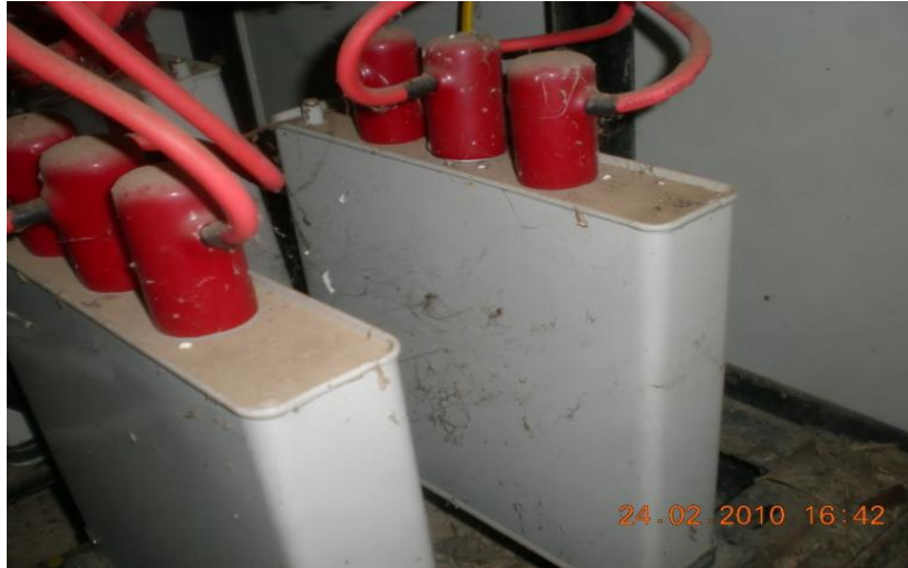
Hình 4.2. Các tụ bù công suất
