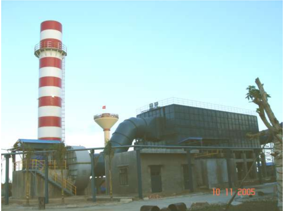
Hình 1.4. Hệ thống xử lý khói bụi
