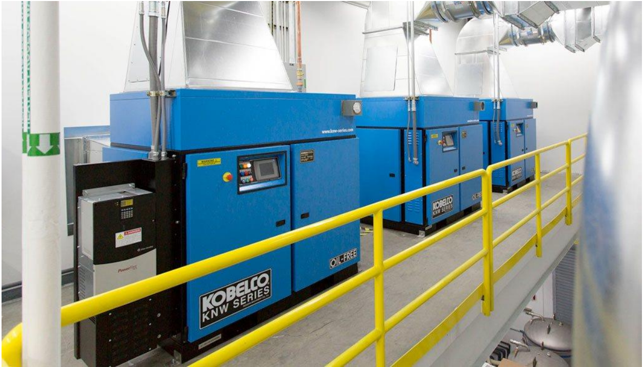
Hình 1.3: Hệ thống máy nén khí công nghiệp
