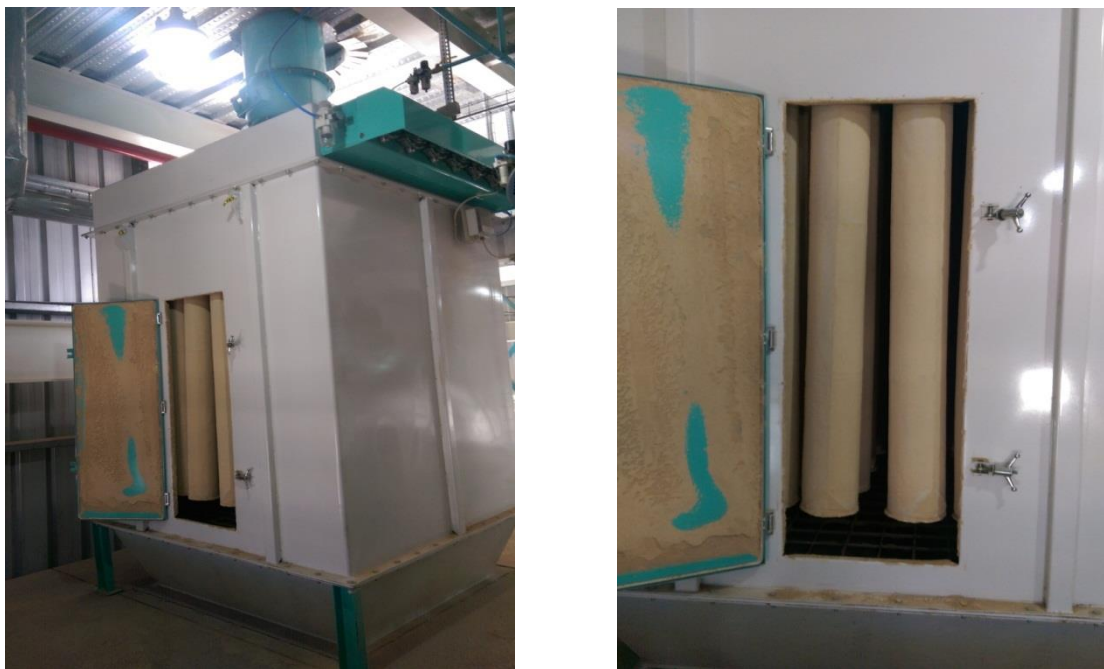
Hình 3.1. Hình ảnh hệ thống lọc bụi túi vải của nhà máy
