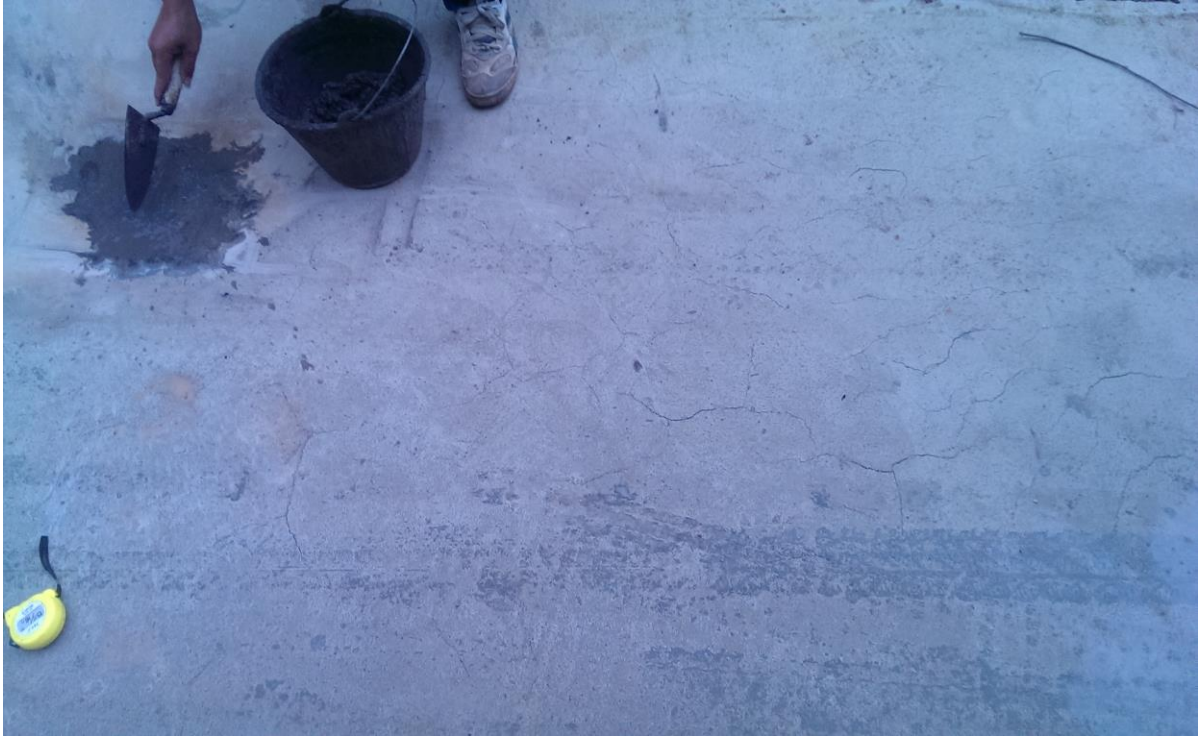
Hình 1.10: Các vết rạn nứt trên hạng mục đường bê tông vào thôn Lương Kỹ, xã Thống Nhất
