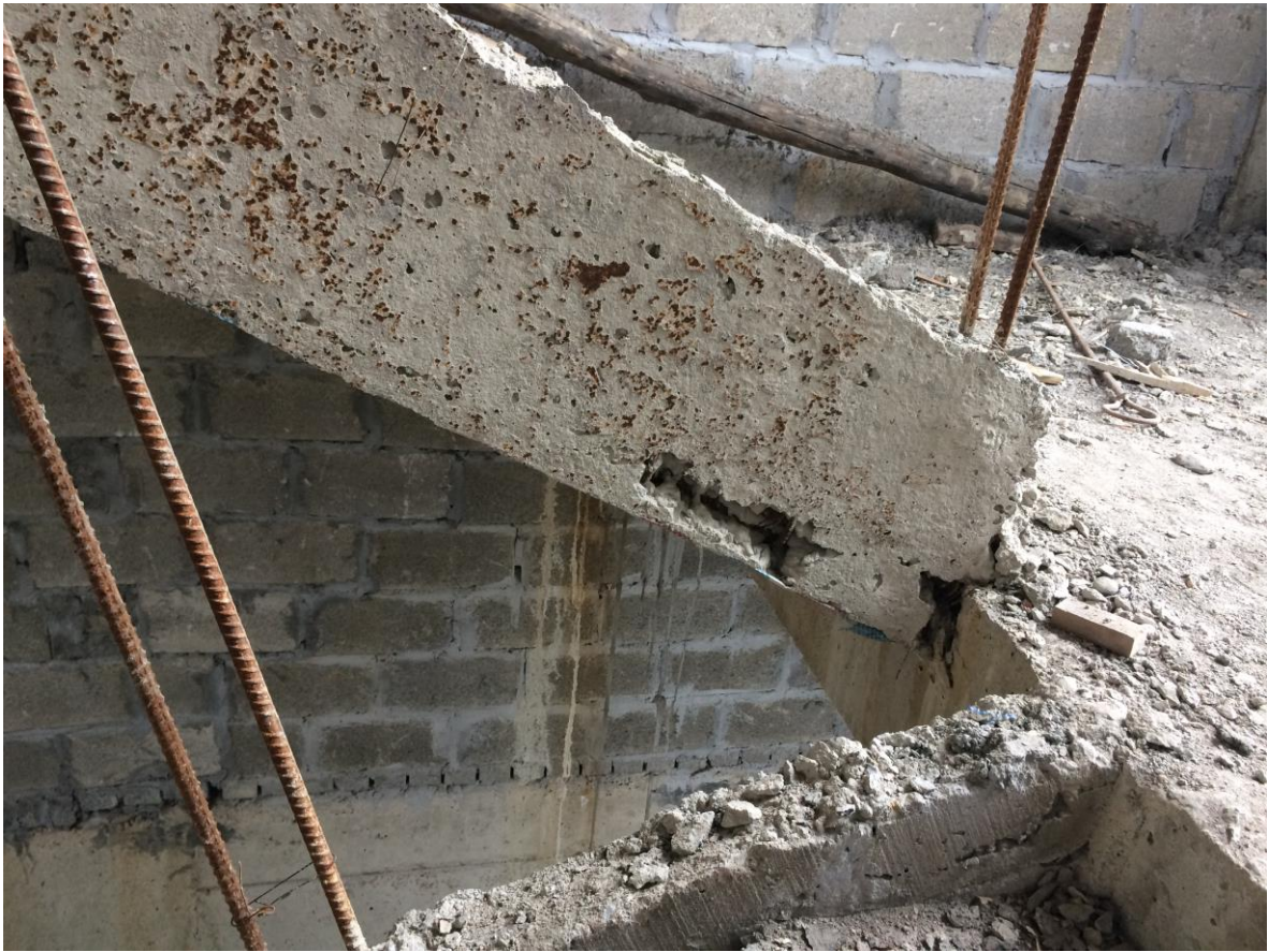
Hình 1.10: Tình trạng bê tông bị rỗ, không đạt yêu cầu sau khi tháo cốp pha tại công trình trường TH&THCS xã Dân Chủ, huyện Hoàn Bô.
