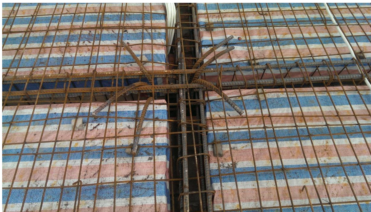
Hình 1.11: Cấu tạo thép không đúng yêu cầu kỹ thuật tại công trình nhà văn hóa xã Sơn Dương huyện Hoà Bình
