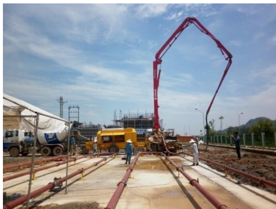
Hình 2.6. Toàn cảnh bố trí lắp đặt hệ ống bơm bê tông thí nghiệm
