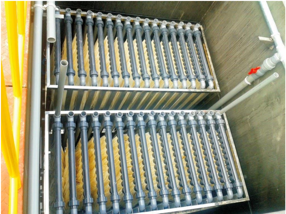
Hình 4.4. Hình ảnh bể lọc sinh học MBR trong thực tế
