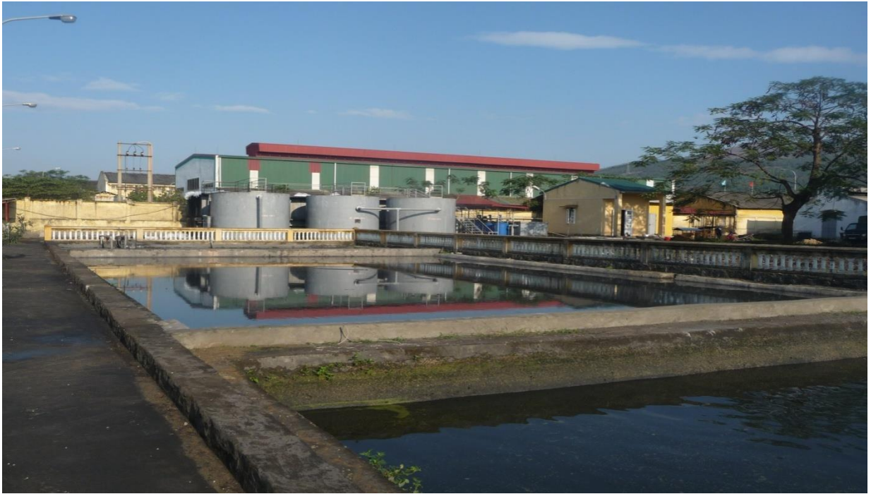
Trạm xử lý nước thải sinh hoạt 300m 3 /ngày.đêm
