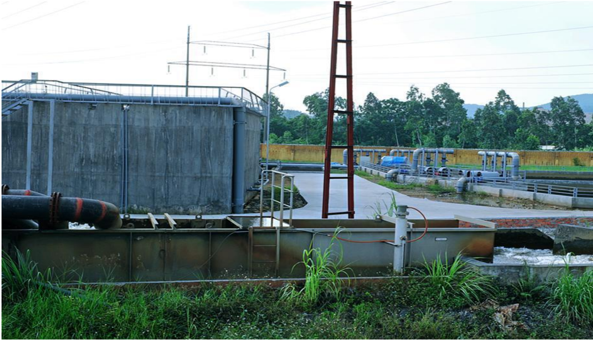
Trạm xử lý nước thải công suất 1200m 3 /h
