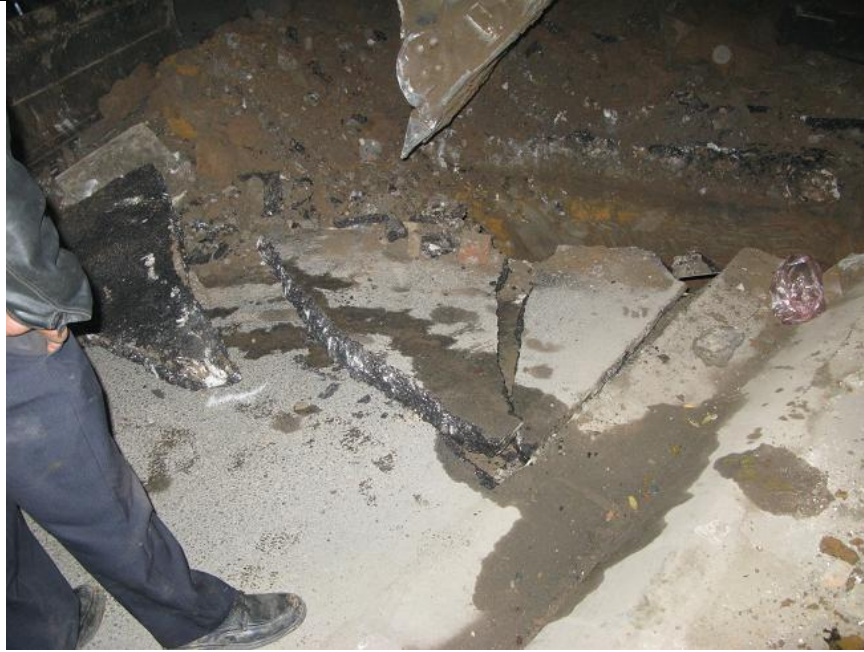
H2.12 Kết cấu bị phá hoại do thiết bị thi công
