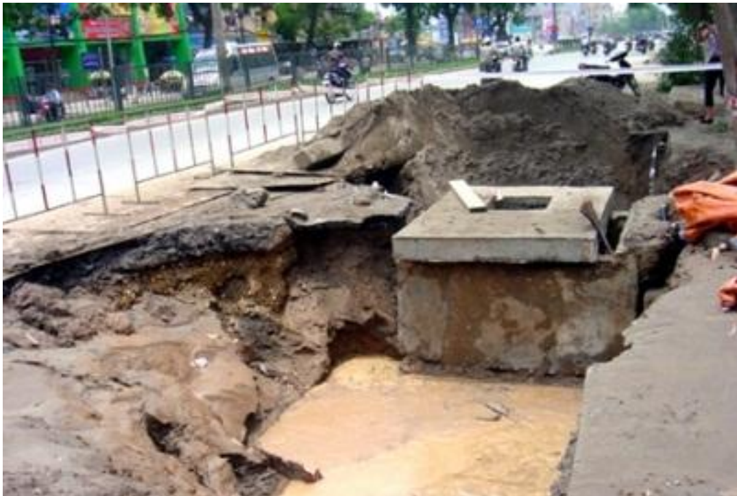
H2.10 Hiện tượng sạt lở khi đào hố móng công trình
