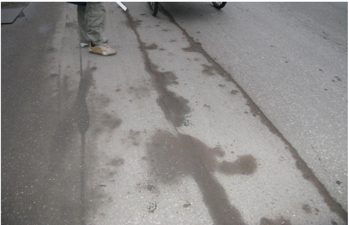
H2.6 Há miệng kéo dài tại mép công trình
