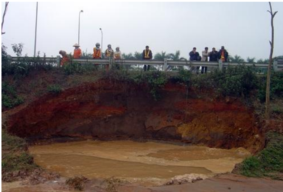
H3.3. Vỡ đường ống nước trên Đại Lộ Thăng Long làm sụp nền đường
