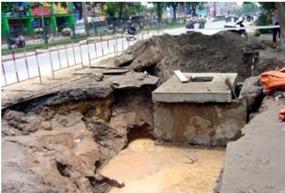
H3.8. Sạt lở mái đào tho công công trình ngầm
