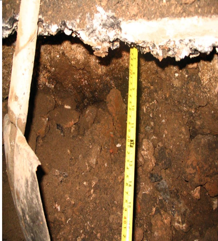
H2.11 Để lại nhiều lỗ hổng lớn khi đào hố móng công trình
