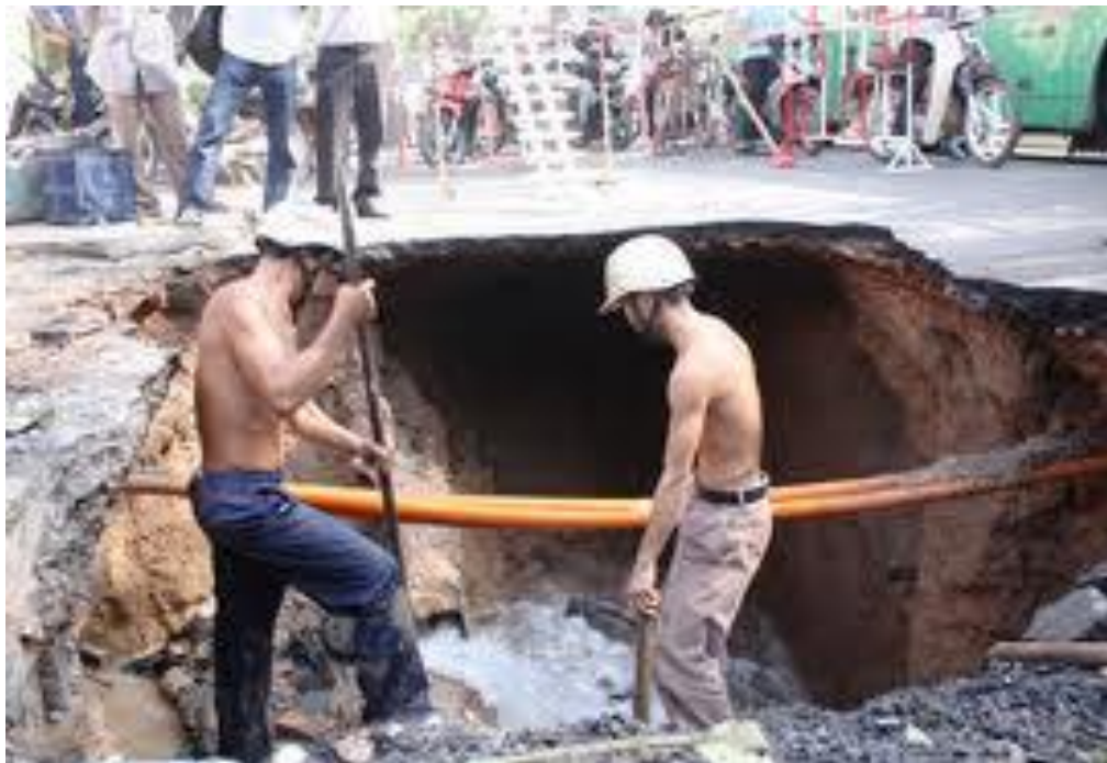
H3.1. Quy hoạch bố trí công trình ngầm không hợp lý
