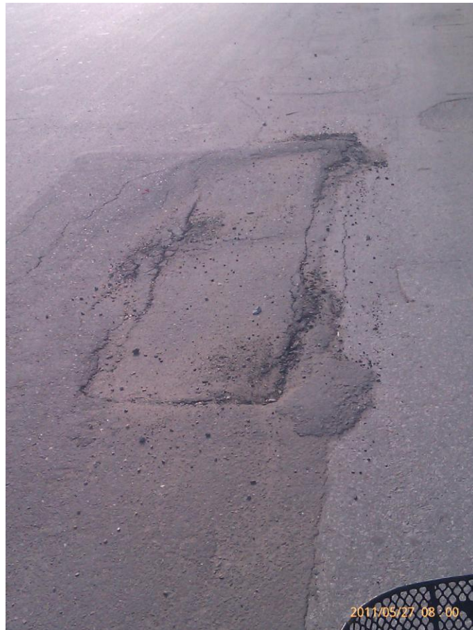
H3.5. Lún, bong bật và há miệng áo đường trên công trình cấp thoát ngầm đô thị
