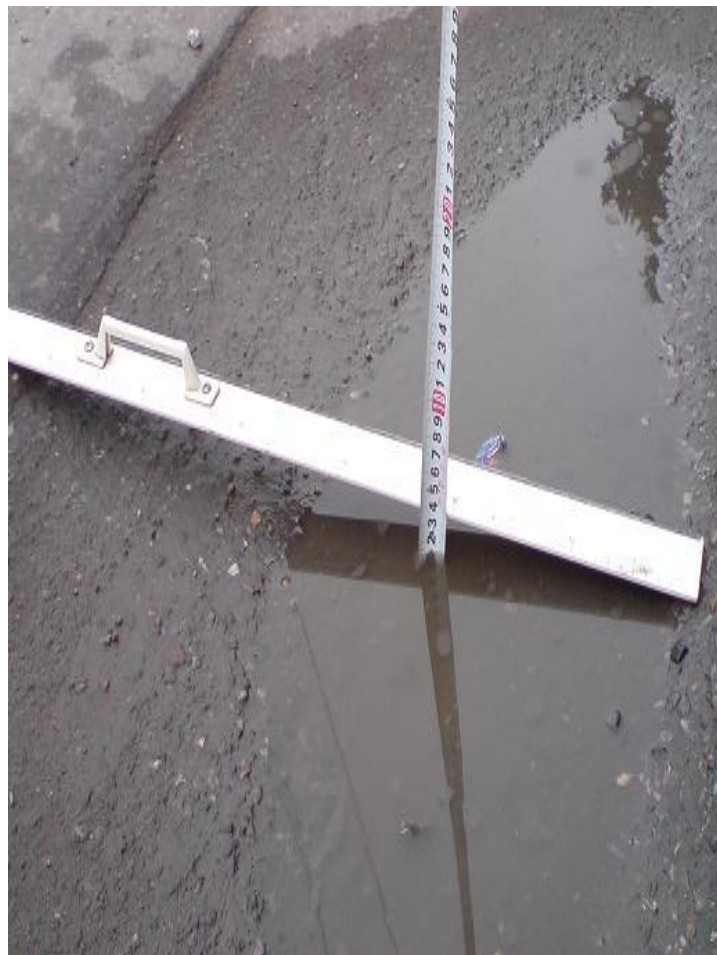
H2.4 Lún trên công trình thoát nước dọc đường
