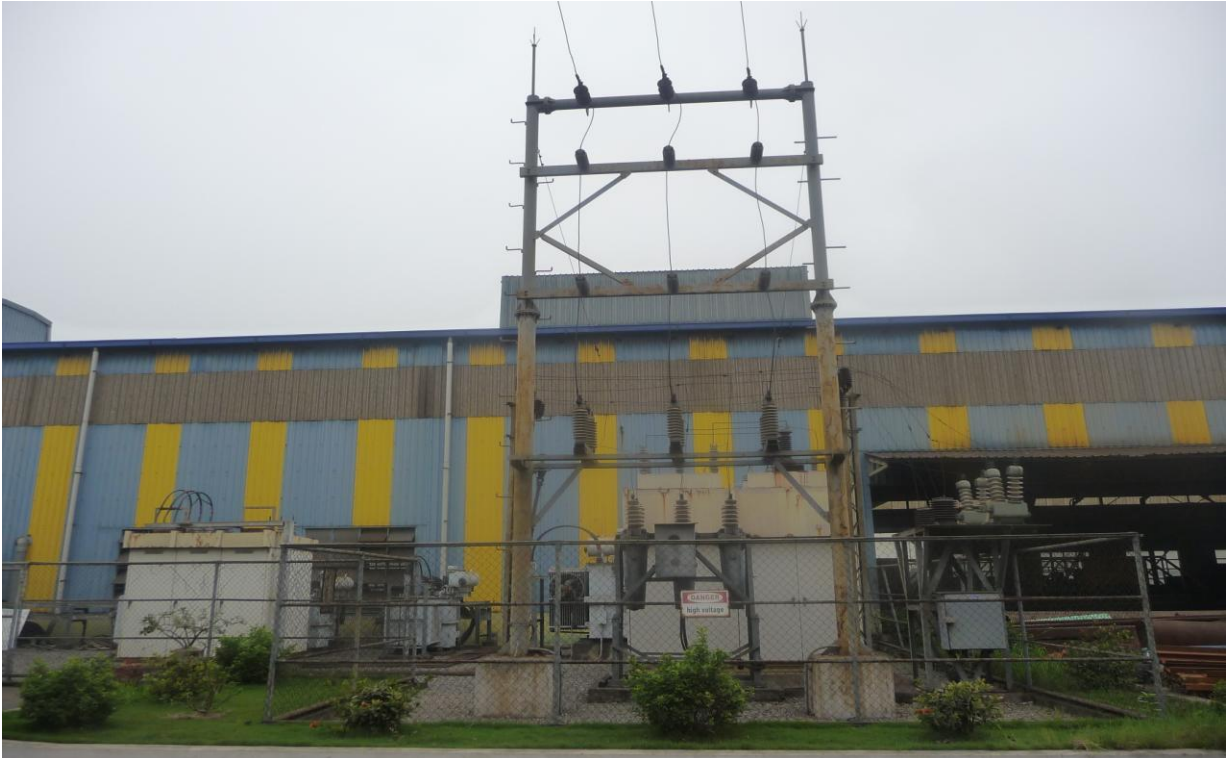
Hình 1.1. Trạm điện của nhà máy
